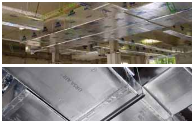
Zdjęcia nr 3 i 4 • Sieć przewodów wentylacyjnych z paneli URSA AIR
